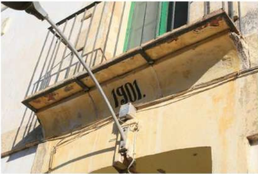
Dintel entrada Casa Forestal, obsèrvese además de la fecha la aglomeración de cableado exterior y el estado del suelo del balcón.
