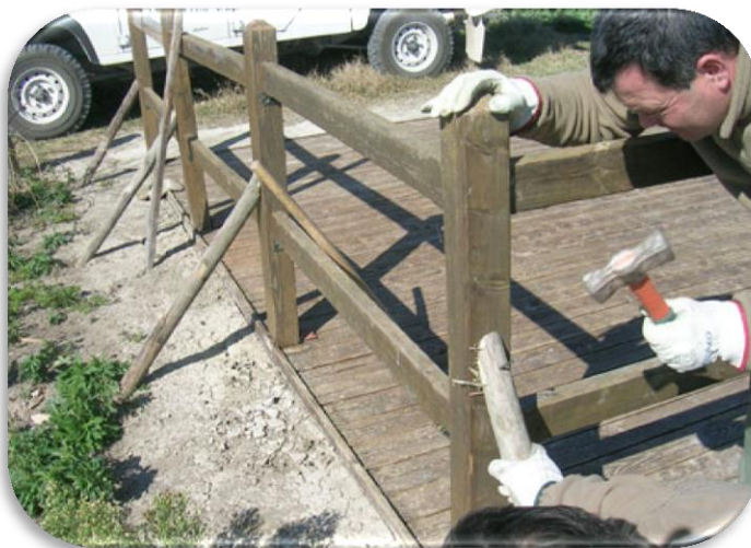
Fotografía 22: Arreglos de equipamientos y señales de uso público en el Área de Reserva del Ullal de Baldoví (Sueca)
