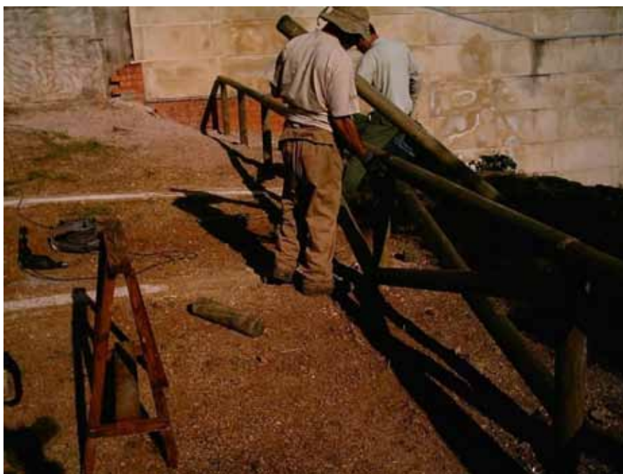
Imagen 10. Colocación de una barandilla de madera en el aparcamiento por parte de la Brigada de Conservación y Mantenimiento. Fuente: Parque Natural Font Roja.
