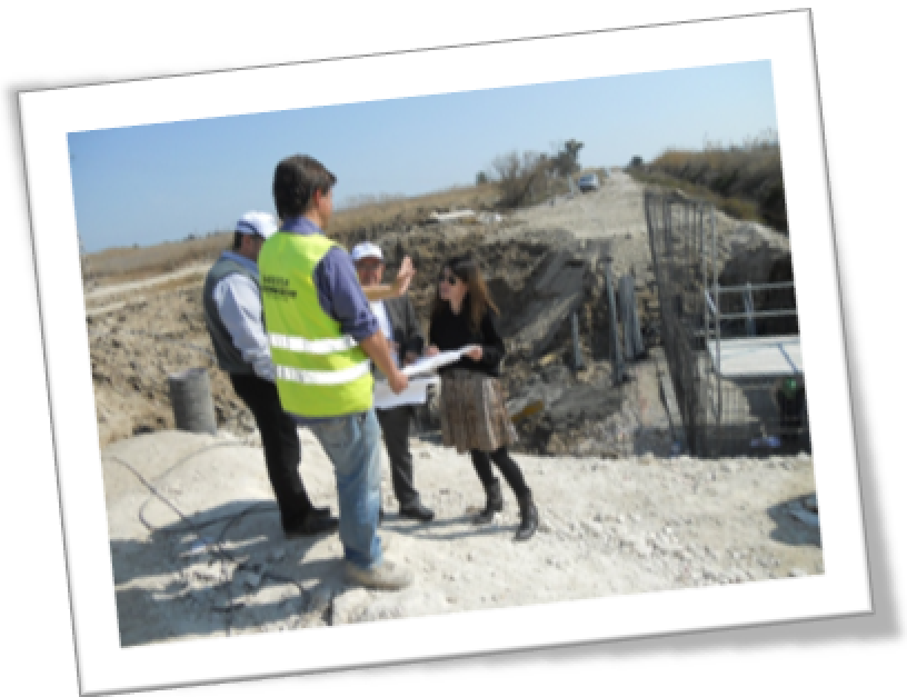
ILUSTRACIÓN 12: SEGUIMIENTO DE LAS OBRAS DE CONSTRUCCIÓN DEL DESAGÜE DE FONDO PARA EL EMBALSE DE PONIENTE
